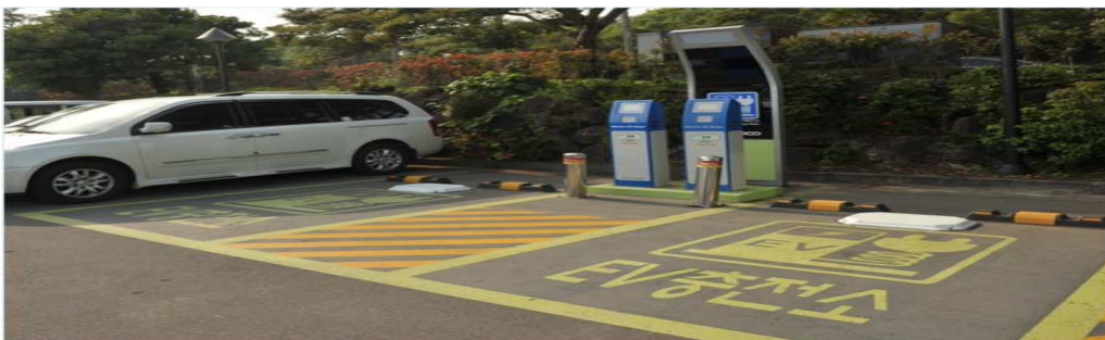
그림. 전기자동차용 무선충전기 실증단지 설치 모습 (3.3kW)
